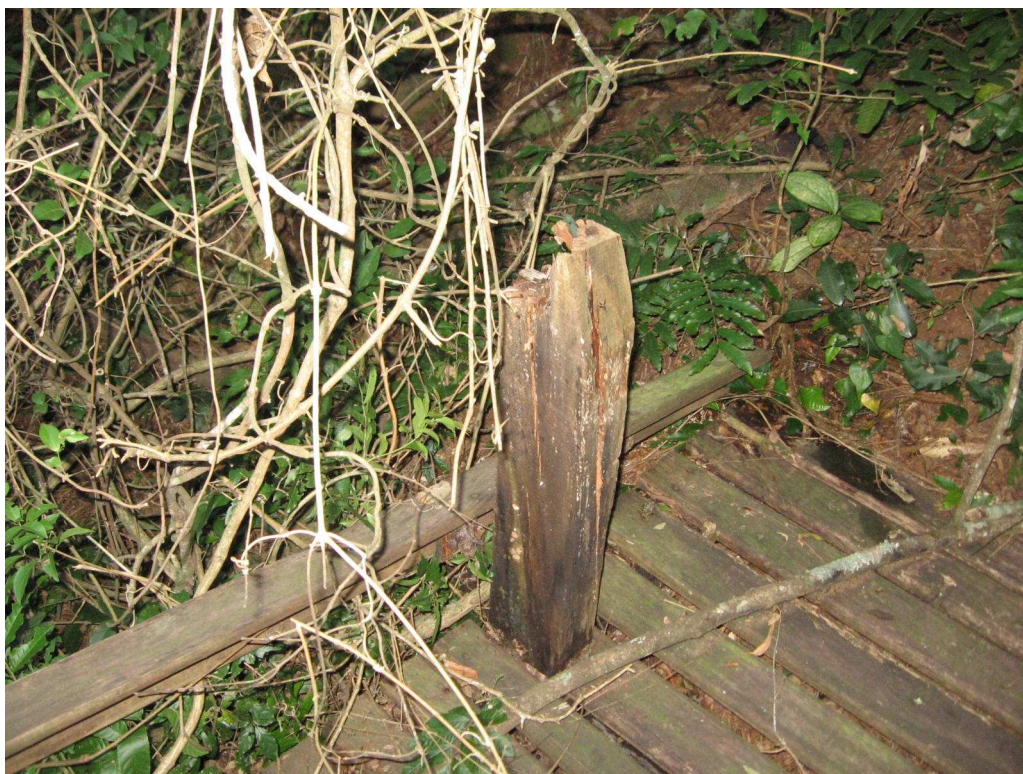
Imagem 27 - Suporte do 'corrimão' quebrado
